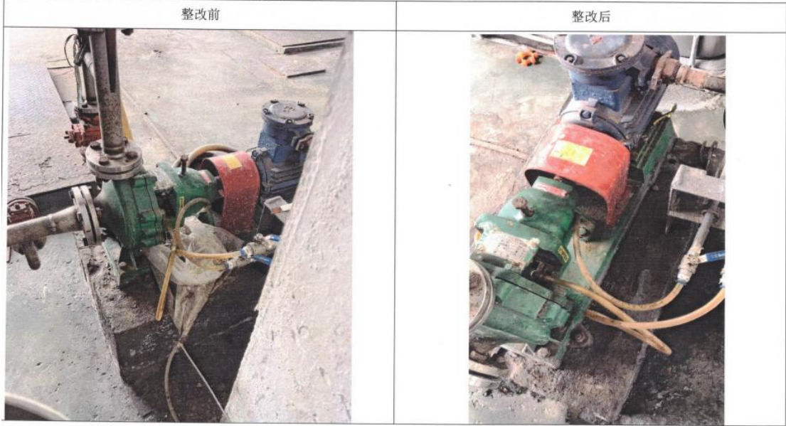
图 3.4-3 隐患排查整改照片
